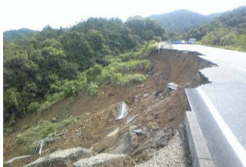
国道435号山口市吉敷畑の崩落現場
