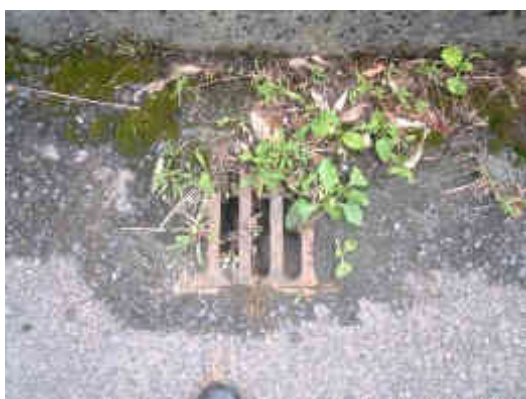
排水装置の土砂詰まり
