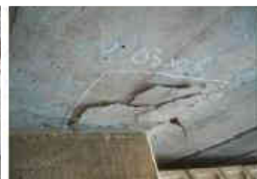
床版部のうき
