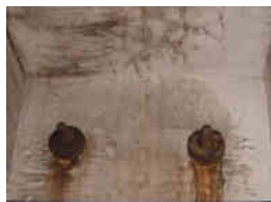
落橋防止装置アンカー一部の 腐食、錆汁*2
