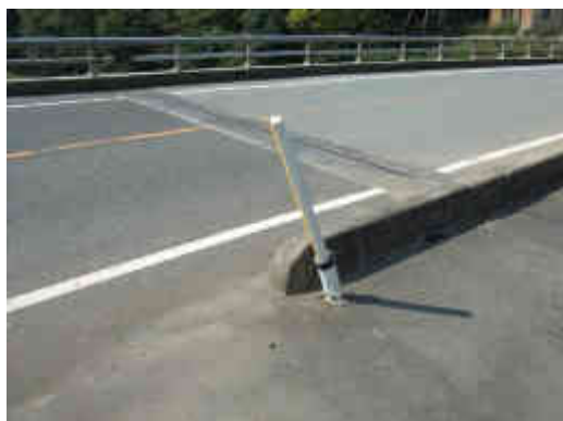
視線誘導標の変形
