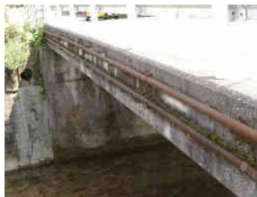
添架物（鋼製管）の腐食
