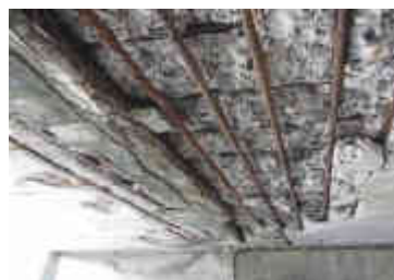
RC 床版橋の鉄筋露出
