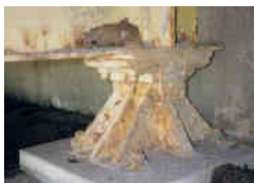
鋼製支承及びボルトの腐食*3
