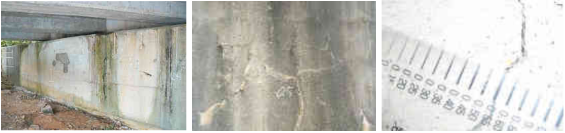
ひびわれ状況
