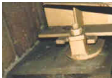
支承の著しい傾き*3
