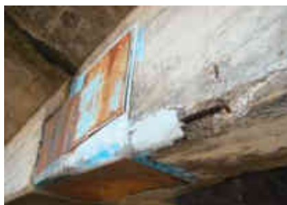
鋼板接着部の腐食*2
