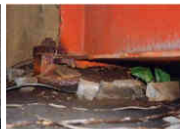
沓座モルタルの欠損*3
