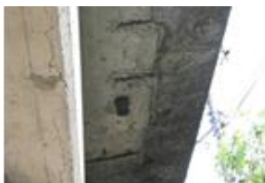
張出部の鉄筋露出
