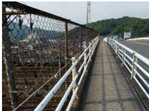
落下物防止施設の腐食
