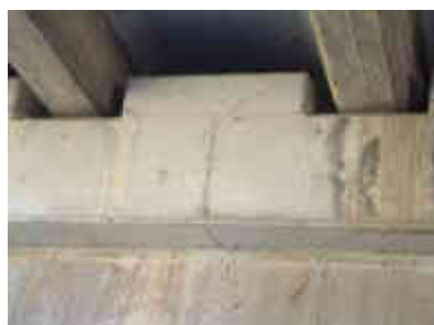
縁端拡幅部のひびわれ
