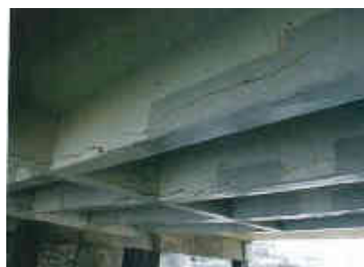
断面修復箇所の再劣化*3
