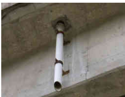
排水管取付部材の腐食
