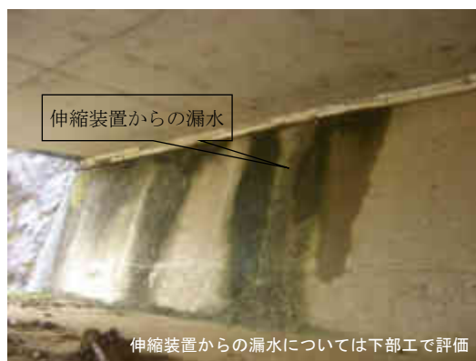
伸縮装置の破損に伴う漏水
