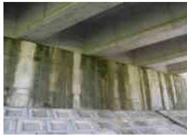
伸縮装置からの漏水 (全面)
