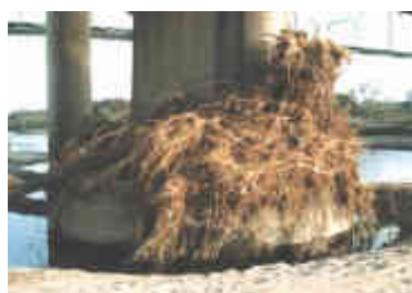
橋脚基礎の洗掘*3
