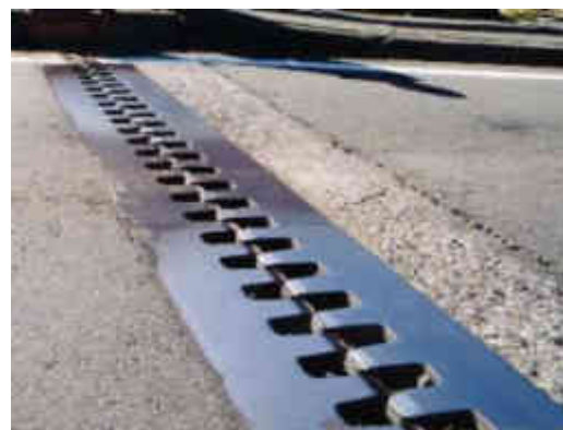
変形、破損に伴う段差*3
