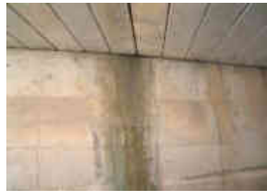
伸縮装置からの漏水 (局部)
