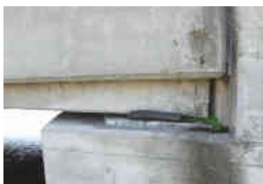
ゴム支承の欠損*3
