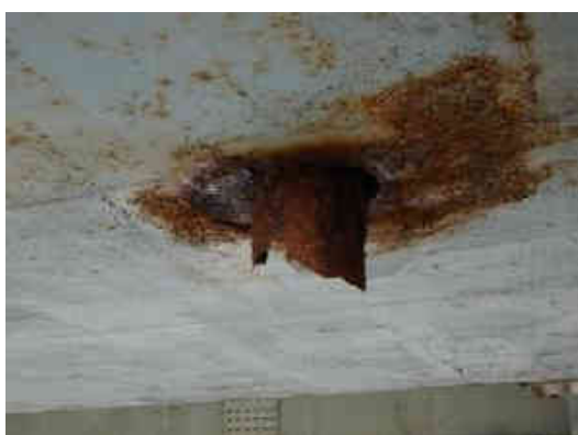
排水管の欠損*3
