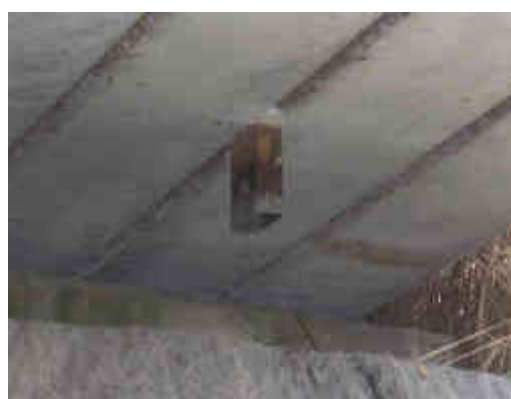
排水管の腐食
