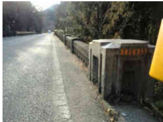
防護柵の高さが不足
