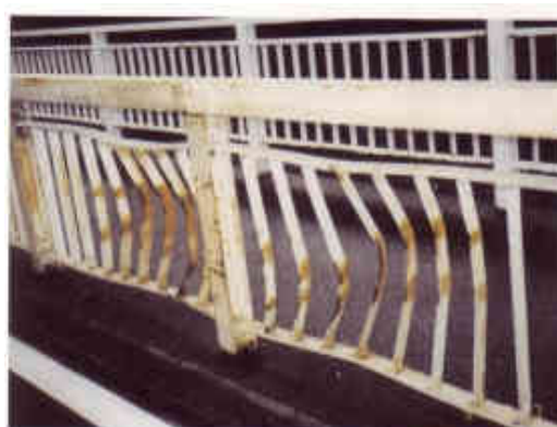
防護柵の変形*3
