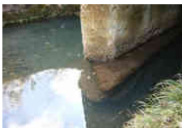
橋脚基礎の洗掘
