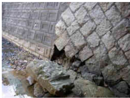
護岸の抜け落ち
