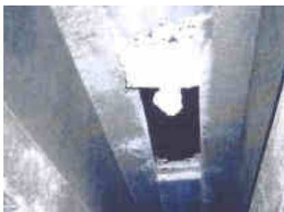
間詰め部の抜け落ち*3
