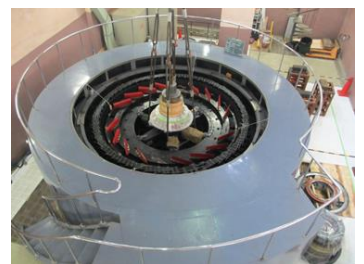
菅野発電所 水車発電機
