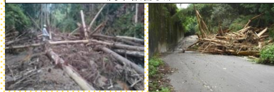
流木被害状況
