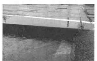
越水寸前の用水路。内水氾濫の原因ともなる状況を打開するための提言を11月議会で発言し、質問。
