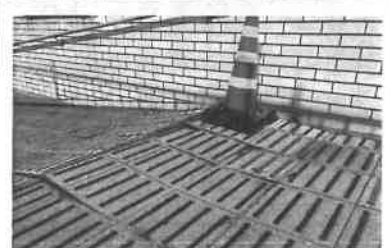
大道・観音口の地下道のタイルが隆起しています！歩行者・自転車などの通行の安全確保に対応。
