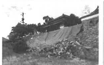
山口県指定の記念物である防府天満宮大専坊跡で石垣と土堀が崩壊。早急な予算確保を11月議会で要望。
