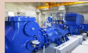
(写真: 宇部丸山ダム送水ポンプ)
