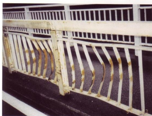
防護柵の変形*3
