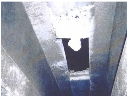
間詰め部の抜け落ち*3
