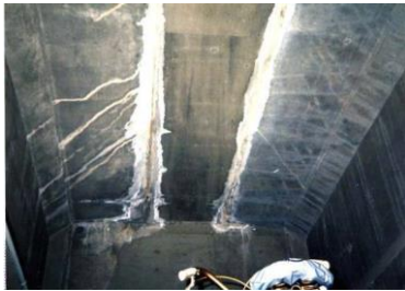
間詰め部の遊離石灰
