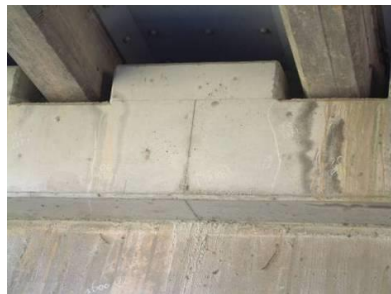
縁端拡幅部のひびわれ
