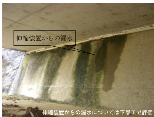
伸縮装置の破損に伴う漏水
