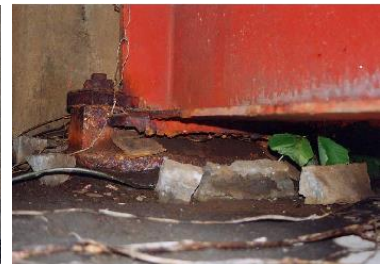
沓座モルタルの欠損*3
