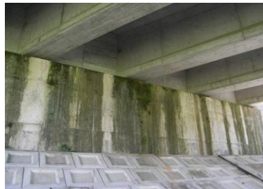
伸縮装置からの漏水 (全面)
