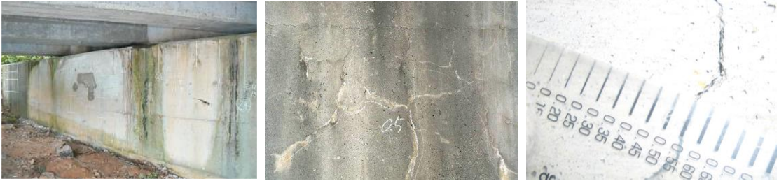
ひびわれ状況
