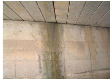
伸縮装置からの漏水 (局部)
