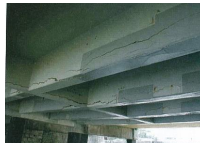
断面修復箇所の再劣化*3
