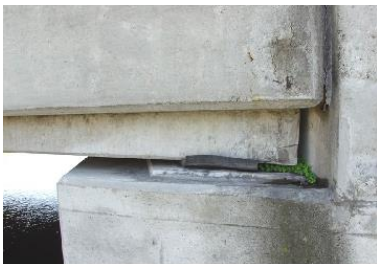
ゴム支承の欠損*3
