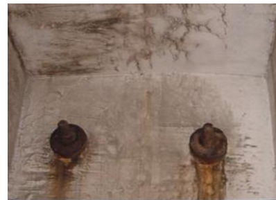
落橋防止装置アンカー部の 腐食、錆汁*2
