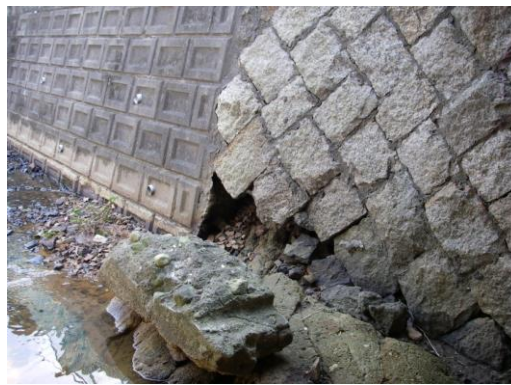
護岸の抜け落ち
