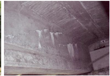
PC 桁シース部の遊離石灰
