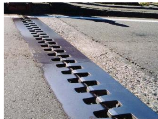
変形、破損に伴う段差*3
