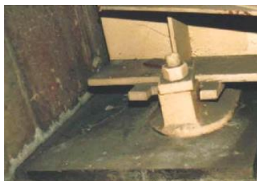
支承の著しい傾き*3
