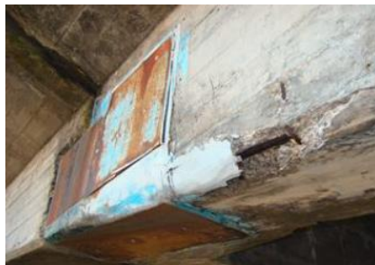
鋼板接着部の腐食*2
