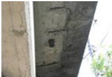
張出部の鉄筋露出
