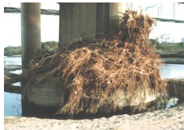
橋脚基礎の洗掘*3
