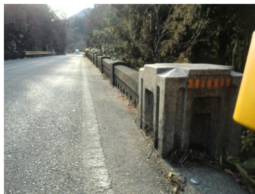
防護柵の高さが不足
