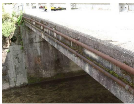
添架物（鋼製管）の腐食
