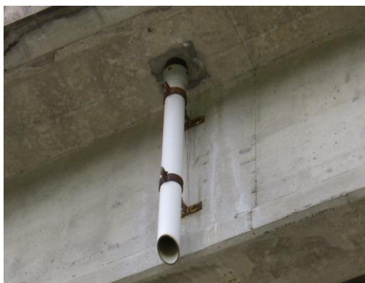
排水管取付部材の腐食
