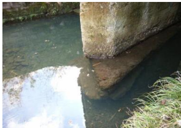
橋脚基礎の洗掘
