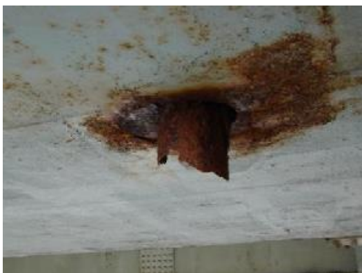
排水管の欠損*3
