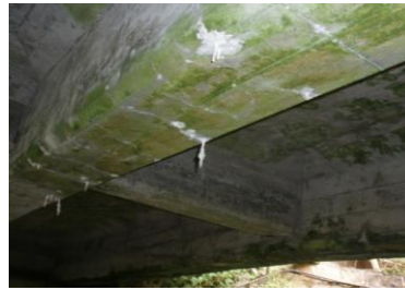
RC 主桁部の遊離石灰
