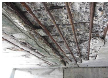
RC 床版橋の鉄筋露出
