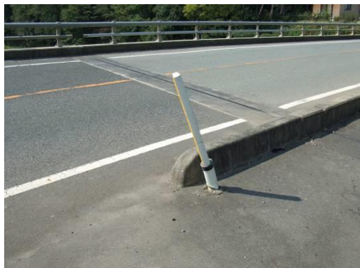
視線誘導標の変形
