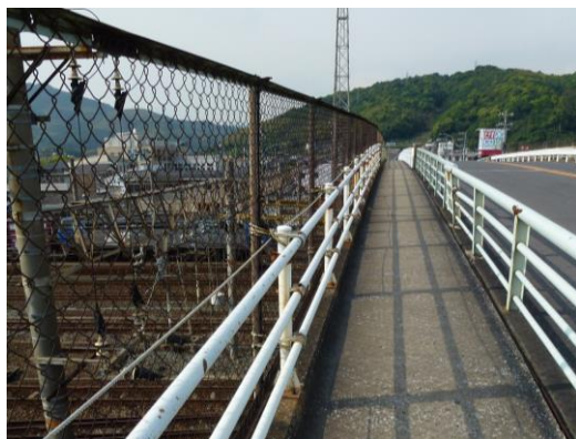
落下物防止施設の腐食
