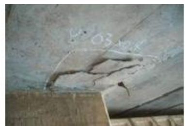
床版部のうき
