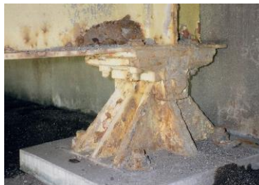
鋼製支承及びボルトの腐食*3
