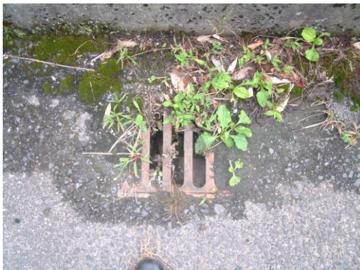
排水装置の土砂詰まり
