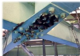
塗装劣化・サビ
