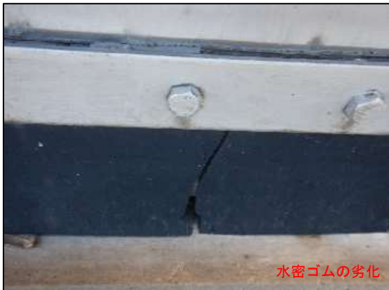
健全度 C* (軽微な劣化や変状がある)
