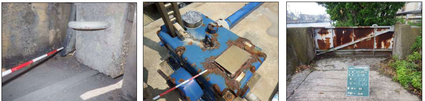
陸閘（水密ゴム破損）
