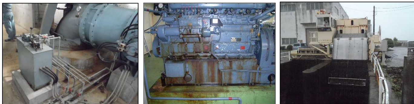
排水施設（主ポンプの腐食）
