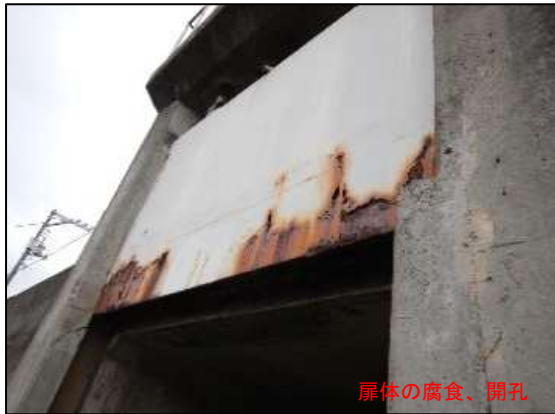
健全度 A* (腐食や変形が著しい)
