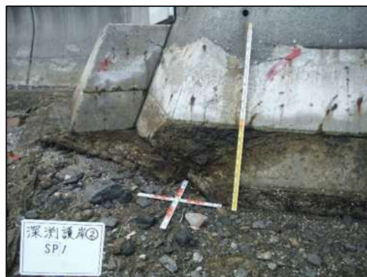
健全度 B (防護機能に影響が有るが空洞化が見られない)
