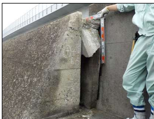
健全度 A (防護機能に影響が有り空洞化が見られる)
