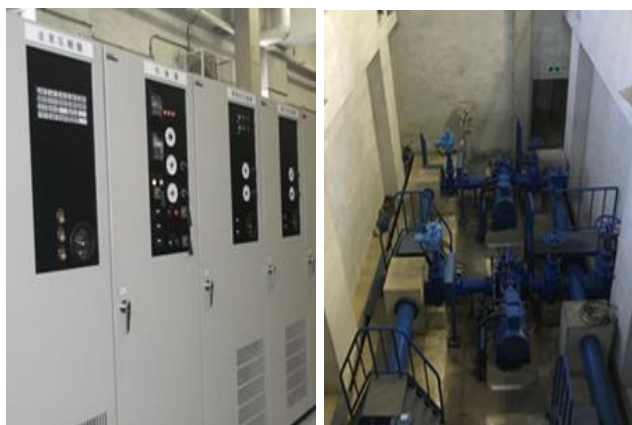
美祢送水ポンプ場電機設備現況
