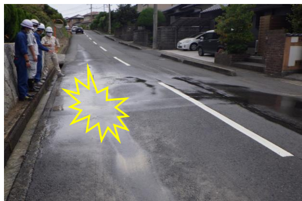
漏水発生箇所周辺
