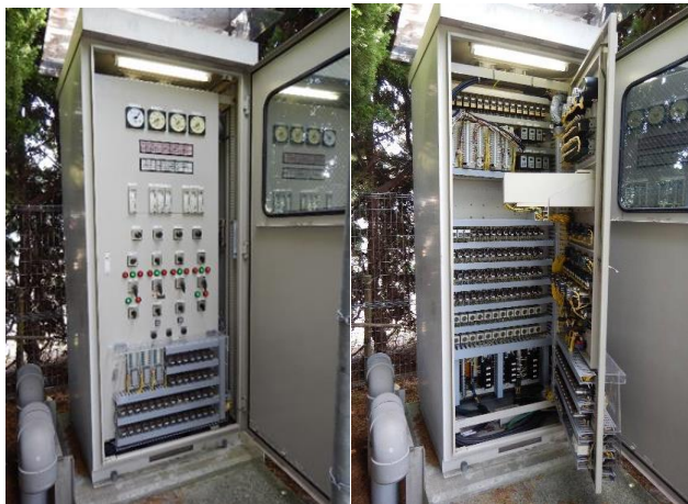
監視制御盤現況 [小瀬川第2期工業用水道事業]
