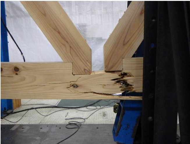
写真7 試験体の破壊状況（西部）
