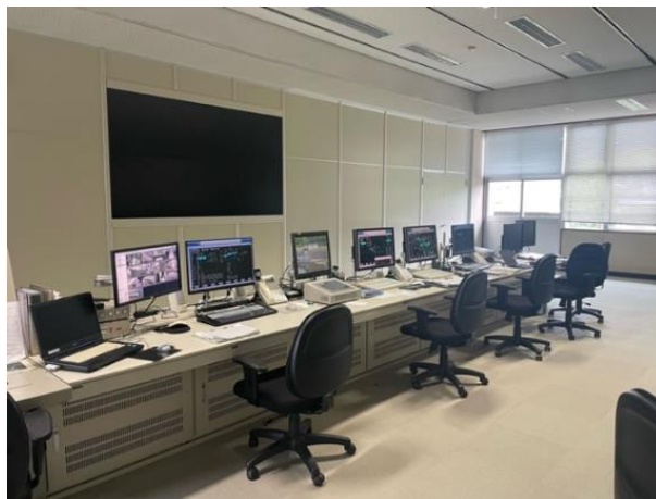
計算機設備現況
