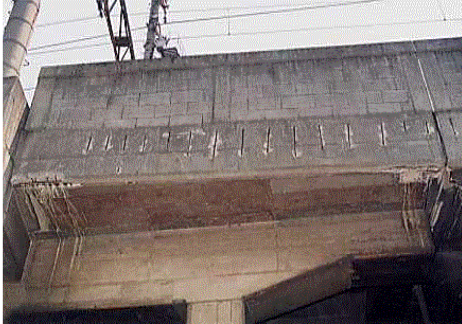
地覆コンクリートからの剥落
