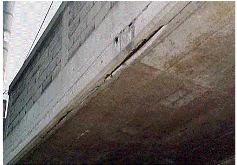
張出しスラブ下面からの剥落
