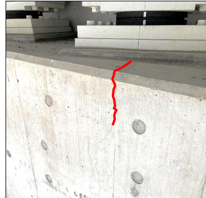
沓座箱抜き部からの 胸壁ひび割れ
