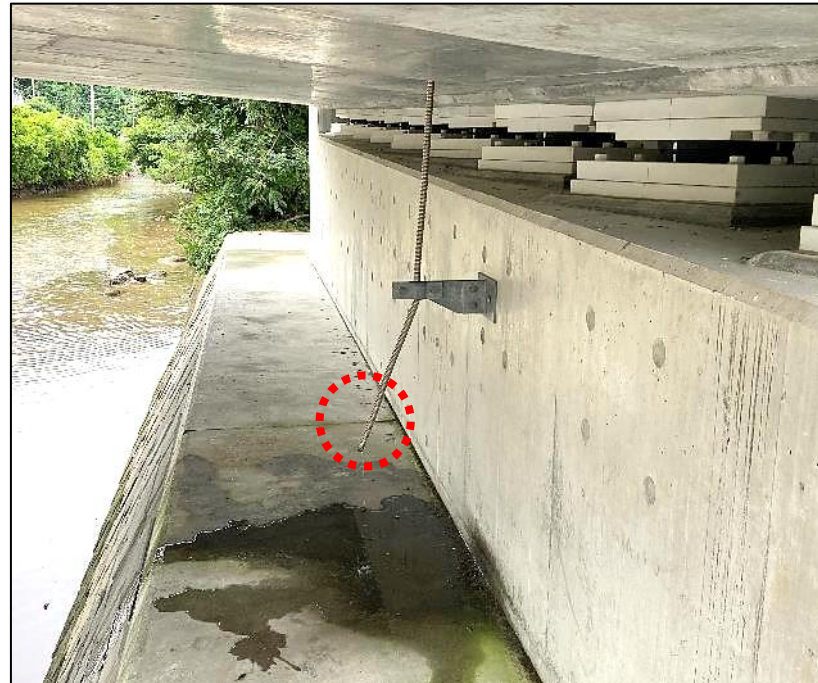
上部工からの排水管の流末 (本来は回避できる水掛かり)
