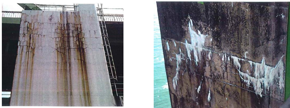
図 2-7 橋梁の損傷事例【橋脚のアルカリ骨材反応による損傷】
