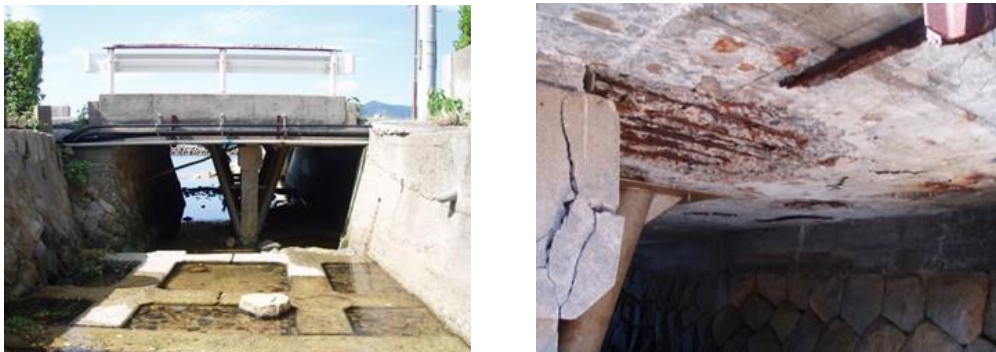
図 2-6 橋梁の損傷事例【RC床版の塩害等による損傷】
