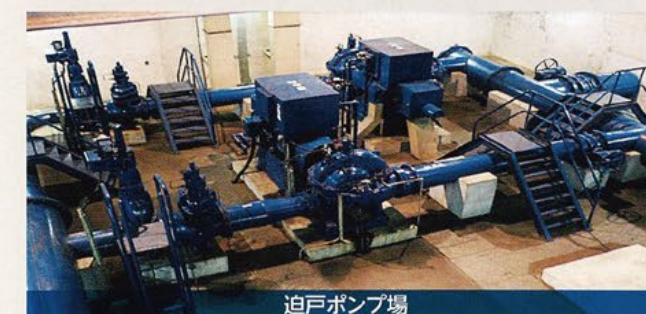
迫戸ポンプ場
