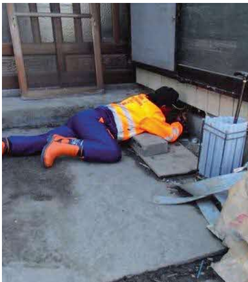
通風口から床下の泥を確認する
