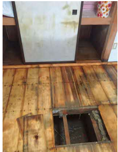
室内の被害状況も撮っておく
