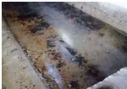
水が残って悪臭が発生する
