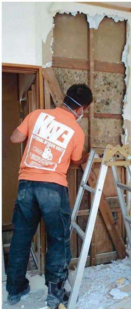
壁をはがすとカビが生えている
