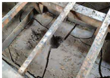
床下にたまった泥（写真③）
