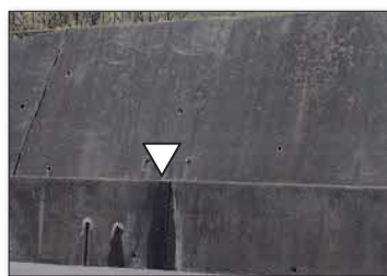
地下水の流出
