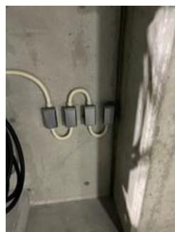
<防災用コンセント>
