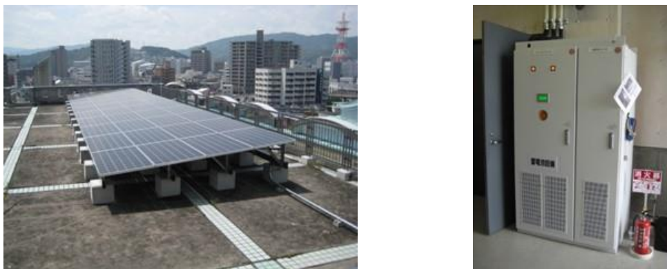
図 2-1-1 岩国総合庁舎設備写真（左：PV システム、右：蓄電池システム）
