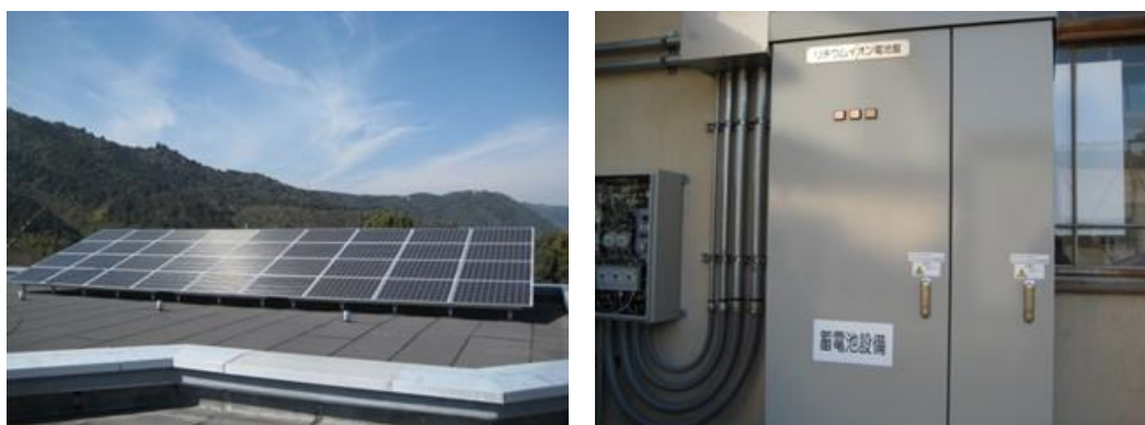
図 2-1-2 岩国高校設備写真（左：PV システム、右：蓄電池システム）
