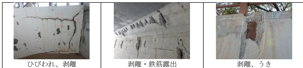
<本体ブロックの損傷状況>
