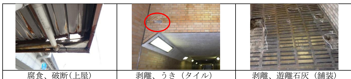
<その他の損傷状況>
