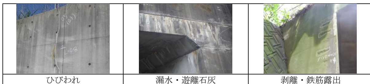
<ウイングの損傷状況>
