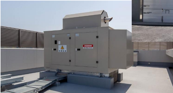
停電時の災害対策機能維持のため、非常用発電機設備を屋上階に設置
