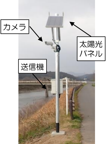
▲河川監視カメラ
