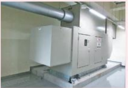
3階 自家用発電機 ▶
