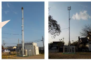
▲防災屋外スピーカー設備
