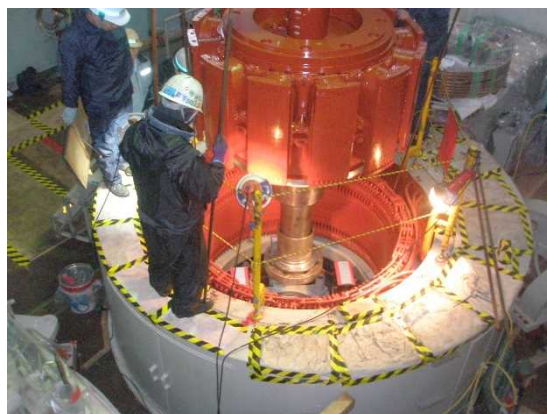
《木屋川発電所 発電機》
