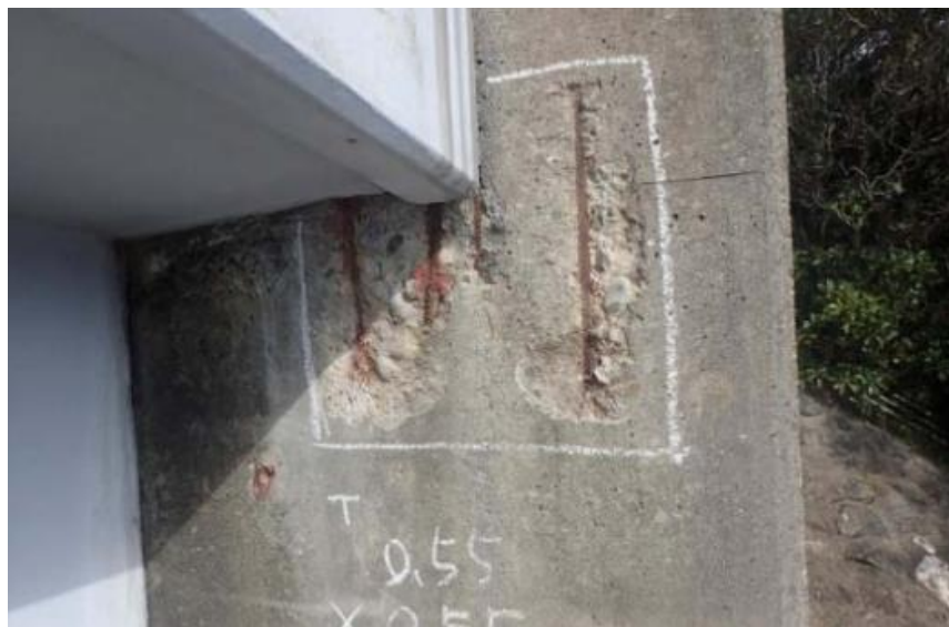
橋台写真 塩害による剥離・鉄筋露出
