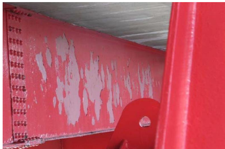
鋼上部工写真 塗装の早期劣化、塗膜の剥落
