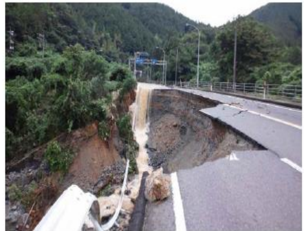
国道 191 号須佐トンネル付近の崩壊
