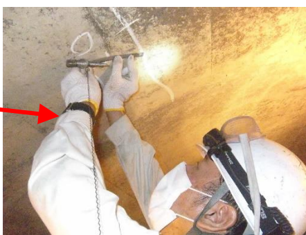
※技術者が直接ひびわれ幅・長さなどを計測
