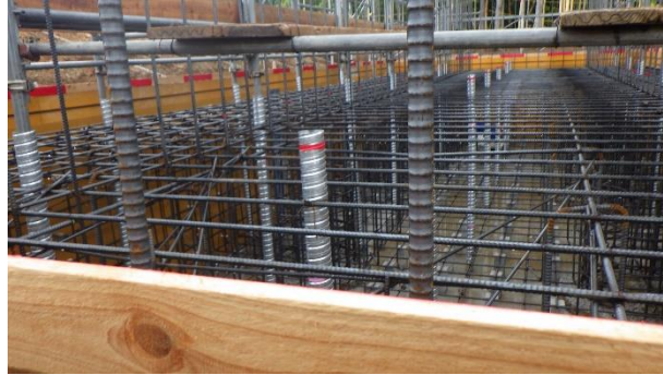
クーリングパイプの配置状況
