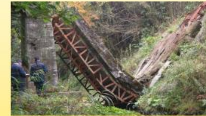
香川・徳島県境無名橋(鋼2径間単純トラス橋)の落橋(2007年)
