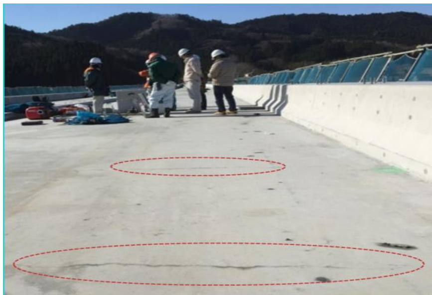
新気仙大橋のRC床版上面 に降雨後に観察できたひび割れ (ただし, 0.2mm未満)
