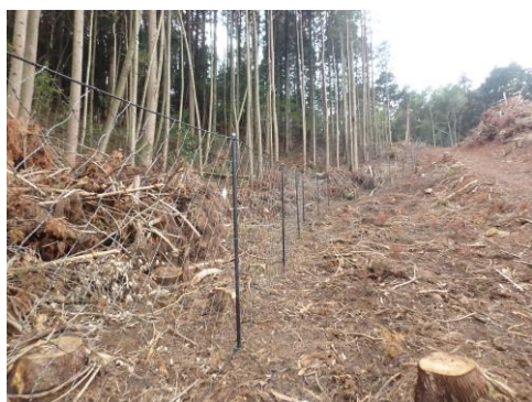
R3 森林環境保全整備事業 [鳥獣害防止施設等整備] シカ防護柵設置事業地 (美祢市)
