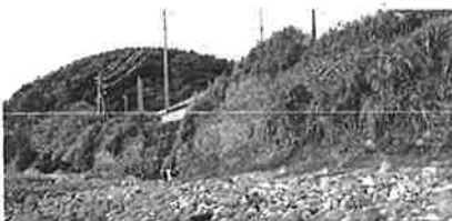
侵食が進む工事前の護岸
