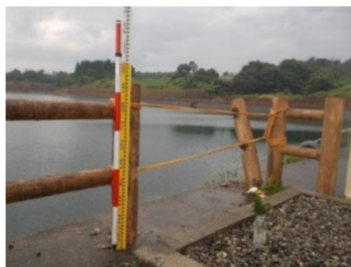
破損箇所にロープ等で進入防止措置を講じ、速やかに補修
