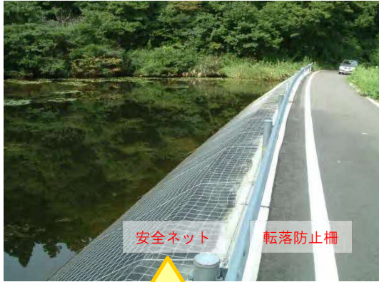
堤体に設置した転落防止柵 (協議により道路管理者が設置)
