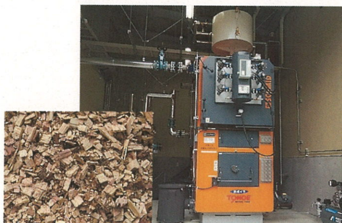
森林バイオマス利用（木質チップボイラー）
