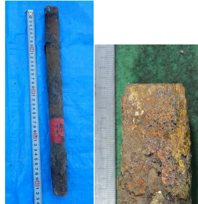
鉛直PC鋼棒①⑦ 腐食状況
