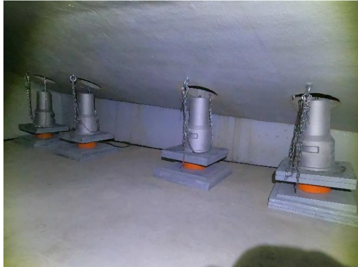
ロードセルによるグラウンドアンカー監視
