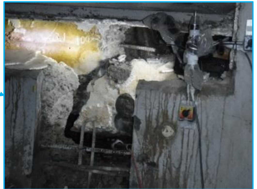
【鋼棒①付近の状況】
