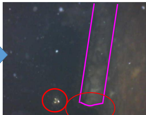
橋座面より、50～60cm 程度下の部分で、P C 鋼棒の破断の可能性のある箇所を確認
