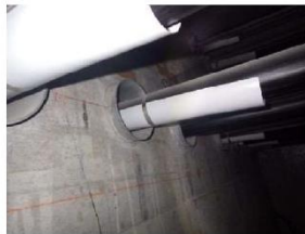
③PC貫通孔状況
