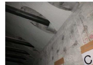
③PC貫通孔状況
