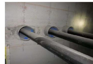
③PC貫通孔状況
