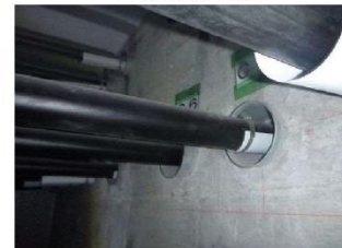
⑨PC貫通孔状況
