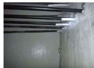
⑪PC貫通孔状況
