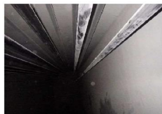
PC鋼材及び上面の状況
