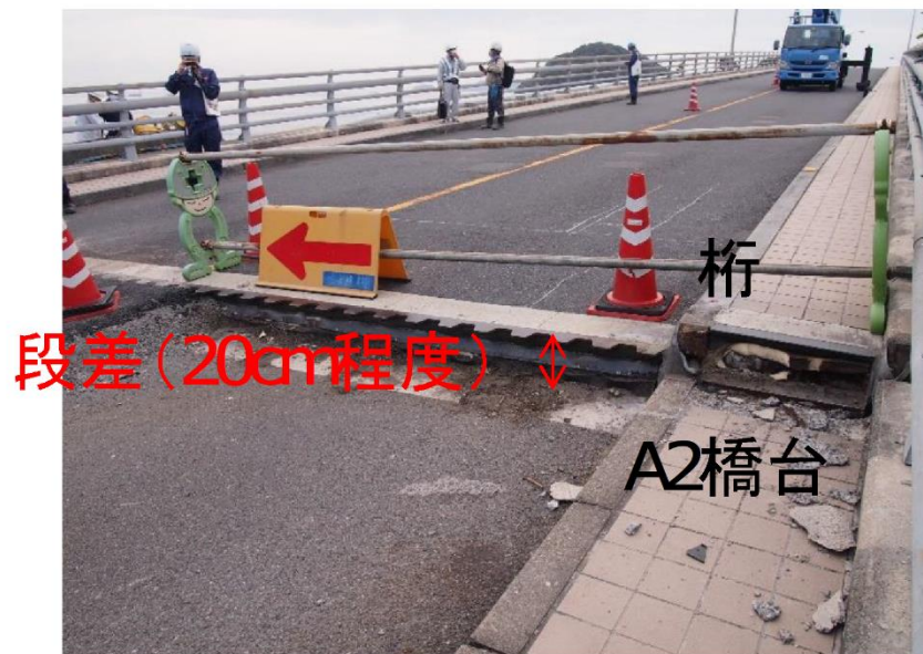
A2橋台上の段差
