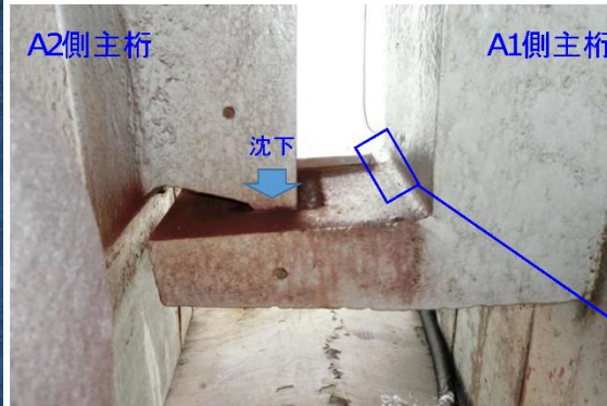
径間中央のヒンジ部の状況
